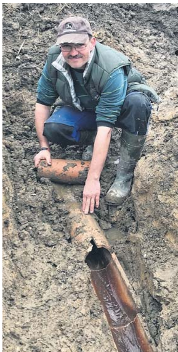
Rohrschaden: Kay Schubert von der Agrar GmbH „Flöhatal“ auf einem Feld bei Flöha. FOTO: OLIVER HACH
