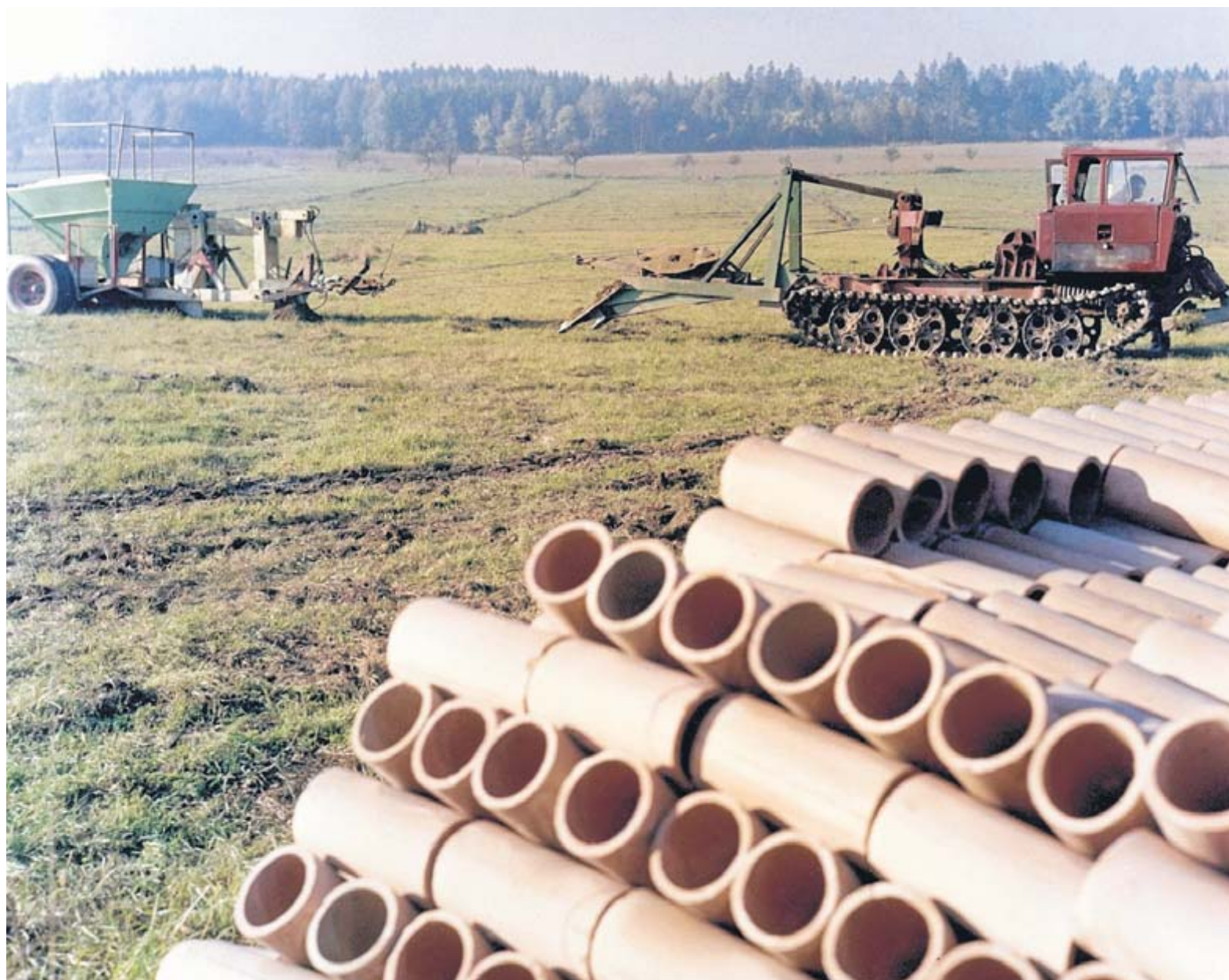
Intensivierung der DDR-Landwirtschaft: Meliorationsgenossenschaften, wie hier 1975 in Dippoldiswalde, durchzogen die Felder systematisch mit Tonrohren zur Entwässerung. Heute sind viele Leitungen marode, Lagepläne schwierig zu beschaffen. FOTO: ULRICH HÄBLER/ULLSTEIN BILD
